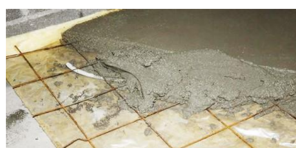
Dalles armées ou non, projection de béton, talus derrière des enrochements, murs de soutènement, retubage de tunnels, rochers artificiels, bâtiments atypiques.
